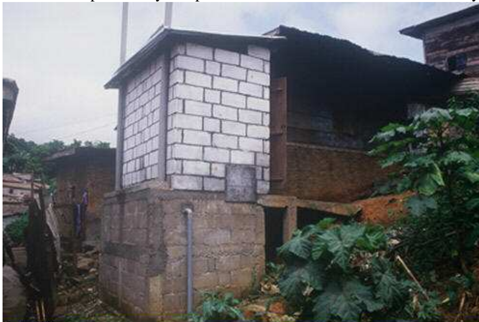
C. Le Jallé Latrine ventilée à double fosse sèche à Yaoundé, quartier de Melen IV (Cameroun)
