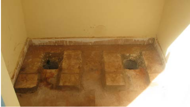
Intérieure de la cabine et trous de défécation
