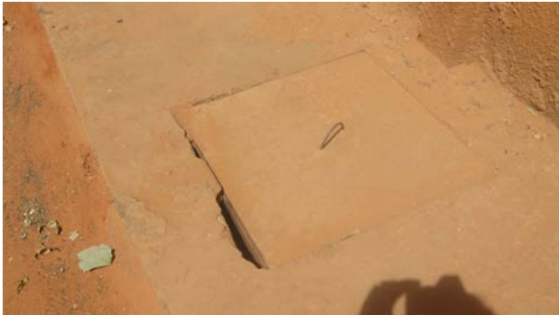
Dégradation au niveau de la dalle amovible donnant accès aux fosses
