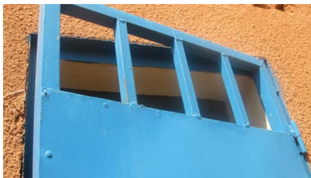
Haut de la porte d'une cabine
