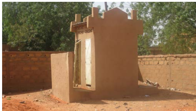
Latrines en mauvais état réalisées hors PEAMU
