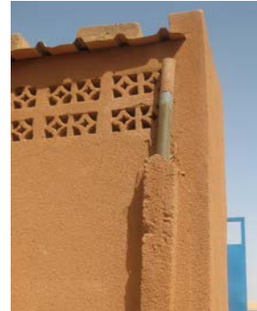
Dégradation de la protection du tuyau d'aération
