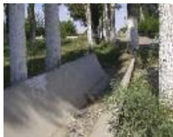
Conduite d'eau vide. © Kai Wegerich
