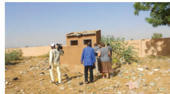
État des latrines scolaires de Zinder en amont du projet
