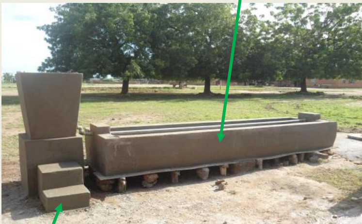
Marches facilitant l'accès au réservoir
