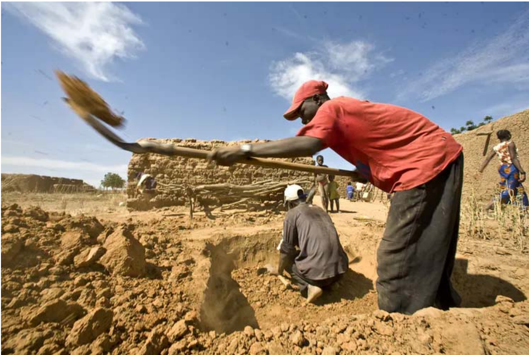
Construction de latrines dans un village de la région de Koulikouro, au Mali, 2009. Harandane Dicko/Unicef Mali
