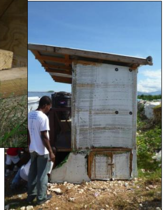
MOVE FOTO T9: Chalè domaje fèy plastik la sou kote yon twalèt UD SOIL.
