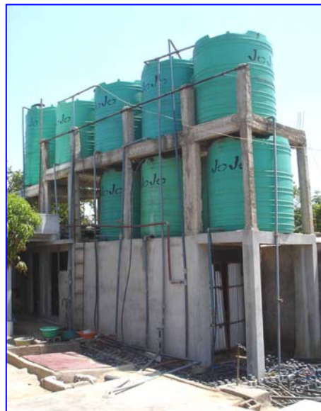
Imagen 1: Estanques privados de almacenamiento en Maputo (Mozambique)
