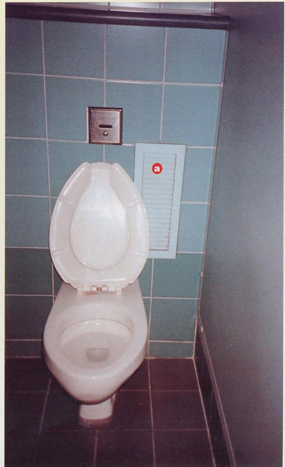
a. Intake Grilles
