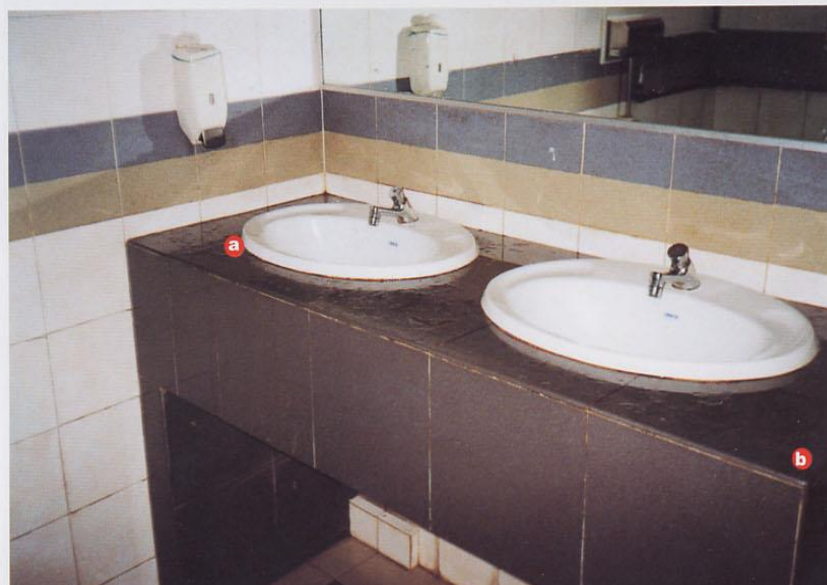
a. Basin Rim Projecting Above Vanity Top b. No Apron Edge
