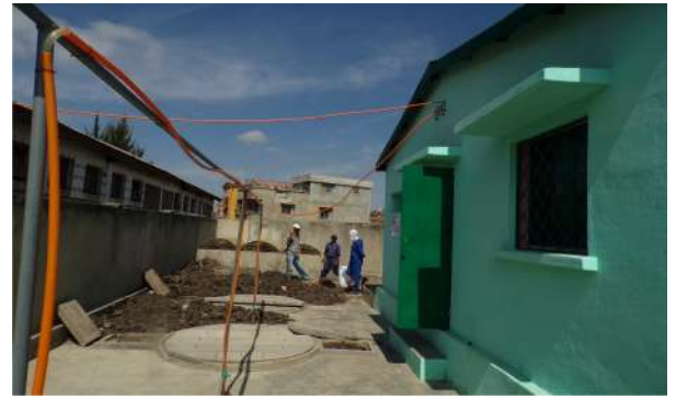
Réhabilitation du Site de Traitement de Boues de Vidange (STBV) de l'EPP Antanjombe Nord (SiMIRALENTA et GeA, mai 2023)
