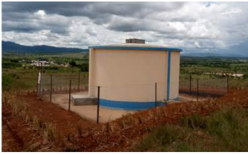
Réservoir de stockage de 50m3
