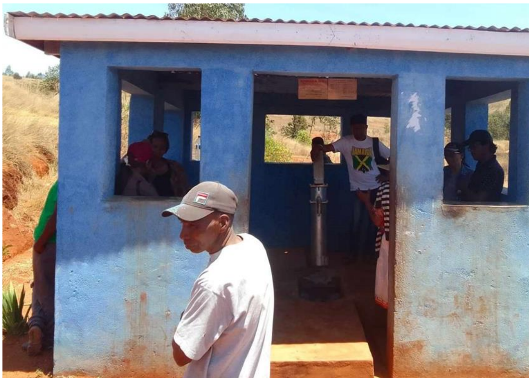
Figure 17 : Pompe à Motricité Humaine de la Commune de Sahafilo
