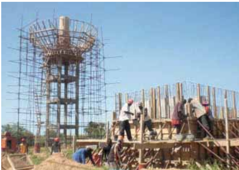
Élévation du château d'eau et du décanteur à Diawara, département de Bakel. Financements : Association des migrants de Diawara (Coredia), PAISD, ville de Paris, Gret (Pacepas)
