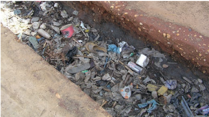
Caniveau bouché par les déchets
