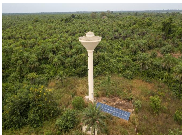
Système photovoltaïque installé en décembre 2023
