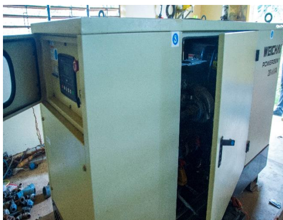
Groupe électrogène de 28KVA installé par le PUDC en 2019
