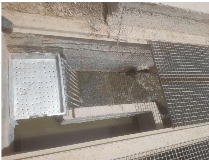
DEGRILLEUR EN ENTREE DU FPR D'ASSAKA, PS-EAU (MISSION JUILLET 2022)
