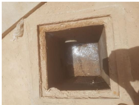
BOITE DE BRANCHEMENT OUVERTE A AKKAL MELLOULNE, pS-EAU (JUILLET 2022)
