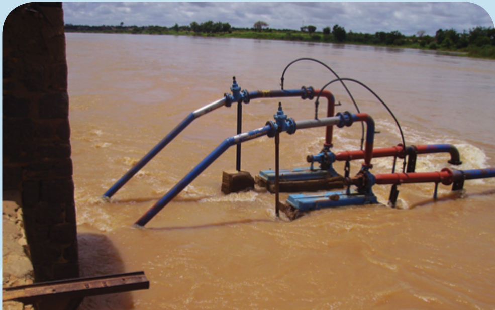
Pompes d'eaux brutes de la station de traitement de Kayes (Mali) submergées lors d'une inondation.
