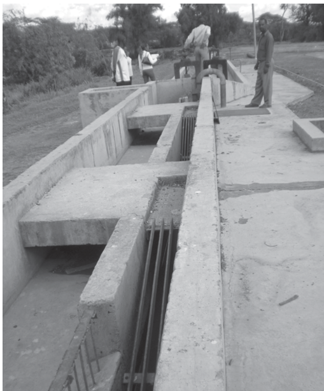
Photo 5.3 Dégrilleur incliné et accessible pour l'opérateur
