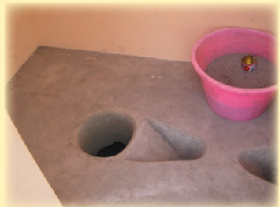
Cuvette de latrines ECOSAN
