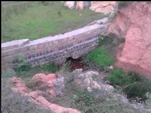
Etat dégradé du barrage après l'inondation post-cyclonique de Mars 2015
