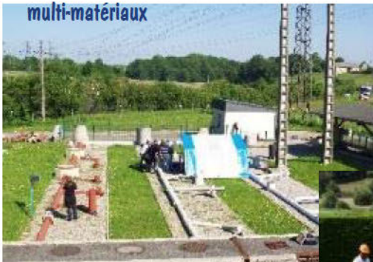
Réseau aérien d'assainissement multi-matériaux
