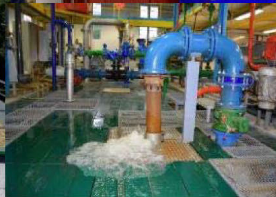
Banc de pompage
