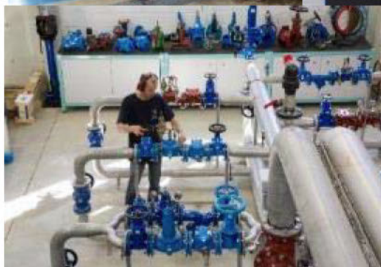
Banc de régulation hydraulique
