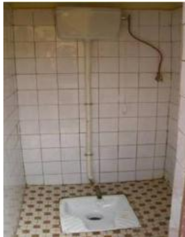
Figure 13 : Toilettes à chasse mécanique avec dalle en céramique
