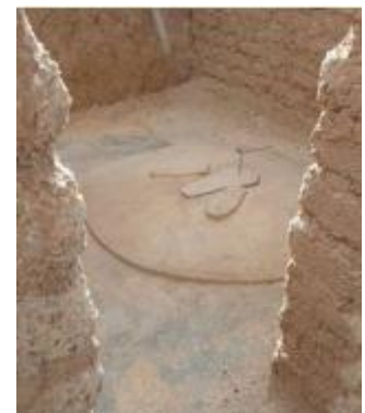
Figure 17 : Latrines à dalle en ciment (type SanPlat)
