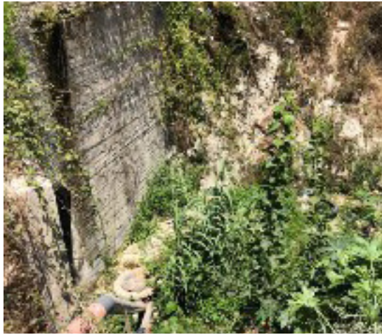
Canalisation rejet eaux usées domestiques
