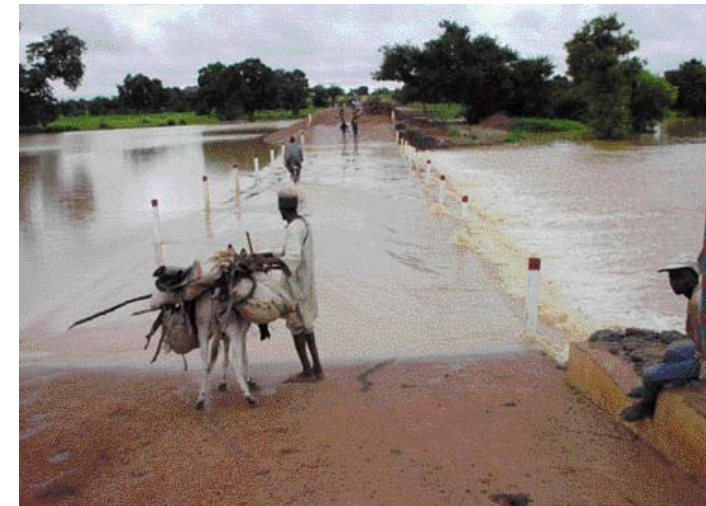
Fig. 4.2.5 Ecoulement d'eau débordant l'évacuateur de crues
