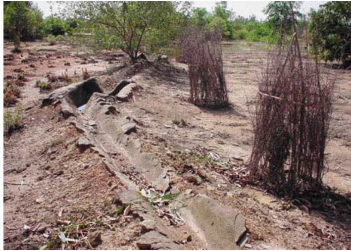
[Canaux en briques séchées au soleil + garniture de mortier] devenus inutilisables à cause de dégâts Emplacement d'installation: plaine d'inondation d'un oued Date de création: 1995 Période d'utilisation: 3 ans
