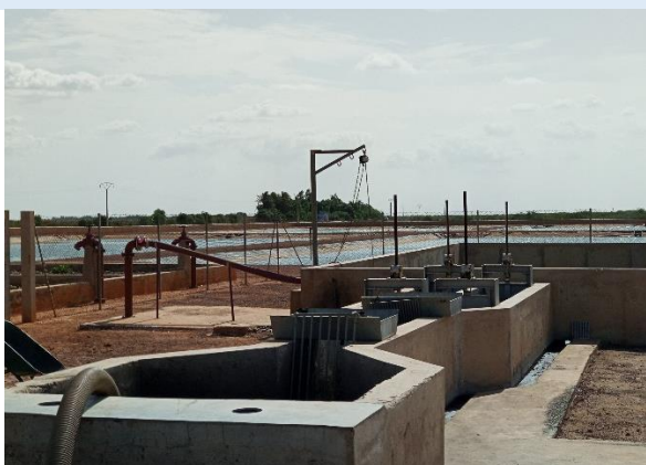
Dispositif de séparation solide/liquide
