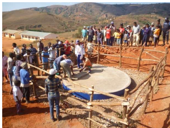
Réservoir de 9m 3
