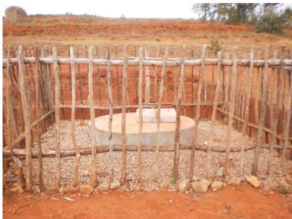
Réservoir de 1,5m 3
