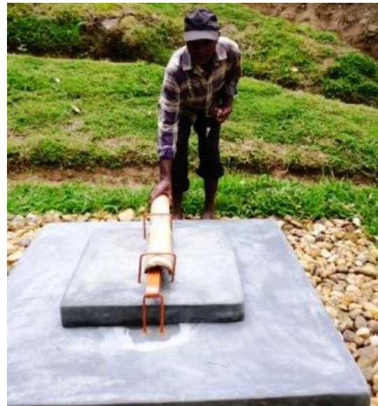
Photo 26 : Système de fermeture de porte en béton ne nécessitant qu'un seul cadenas
