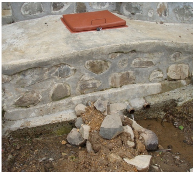
Photo 12 : Exutoires des trop-pleins vidange à ras du sol, la probabilité qu'ils se bouchent est importante.
