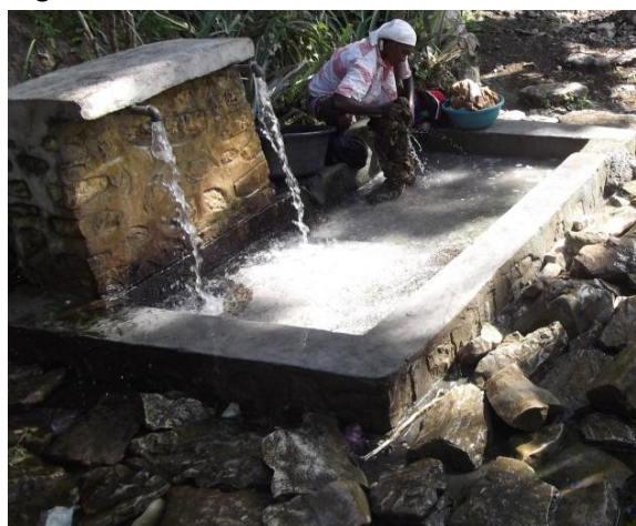
Photos 38 : Alentour de la dalle de service boueuse à cause des éclaboussures de la borne fontaine (Débit 70 l/min, H chute \approx 70 cm, Muret 15 cm)
