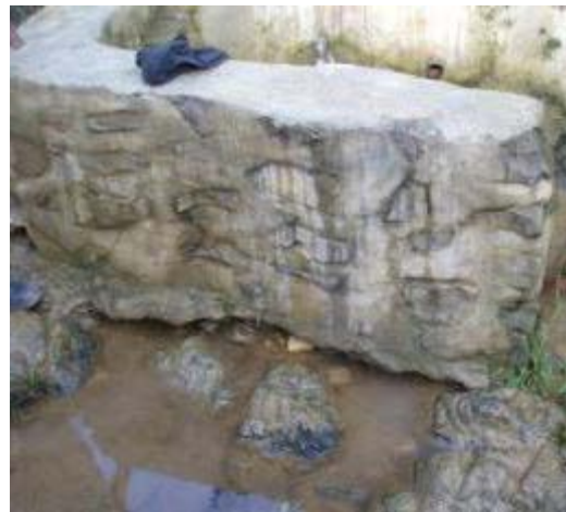
Photo 3 : Muret de protection d'une dalle de service de boîte/fontaine érodée par la ravine : fondations pas assez profondes et matériaux trop peu résistants
