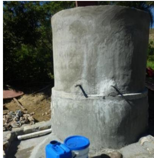
Photo 58: Trop-plein avec exutoire crépiné (déconseillé)
