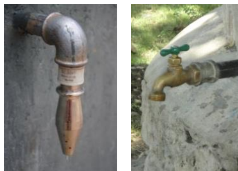
Photo 79 : Robinets Talbot et locaux
