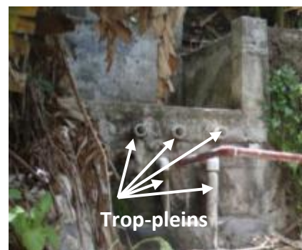
Photo 13: Boîte captage avec 5 trop-pleins en 3''
