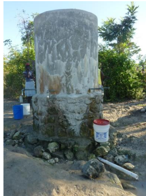
Photo 60: Citerne très érodée : pas de dalle de service, exutoire du trop-plein non protégé, pas de système antiérosif.
