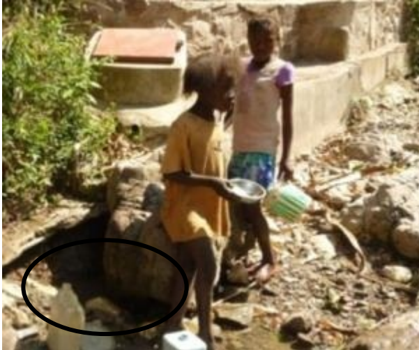
Fuite totale passant sous les fondations de la boîte de captage.
