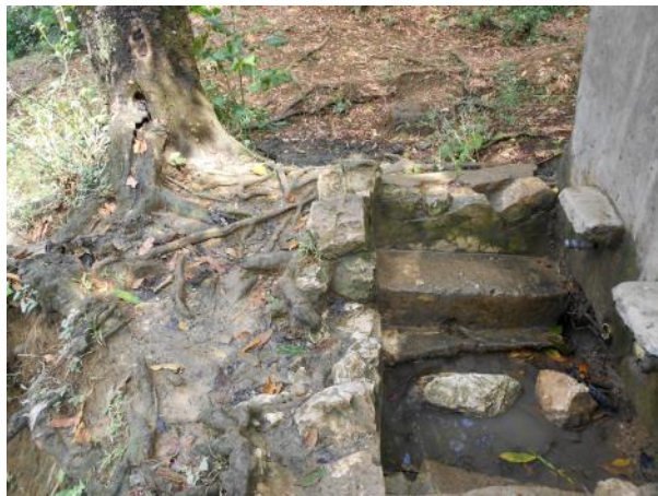
Photo 6 : On imagine aisément qu'au moment de la construction il y a 20 ans cet arbre ait pu paraître inoffensif
