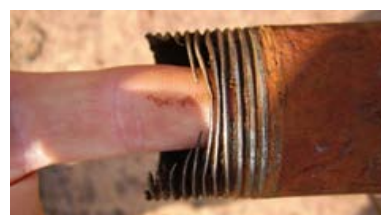
Corrosion du filetage d'un tuyau galvanisé
