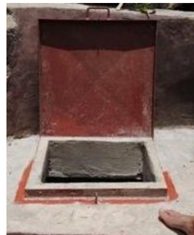
Photo 31: Protection contre les infiltrations à la jonction porte dalle
