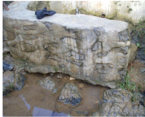
Photo 84: Base de la structure érodée nécessite au moins un enrochement pour protéger la base de la fondation
