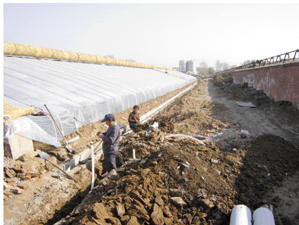
SWITCH appui la Coopérative Huairou dans l'amélioration de l'utilisation des eaux pluviales
