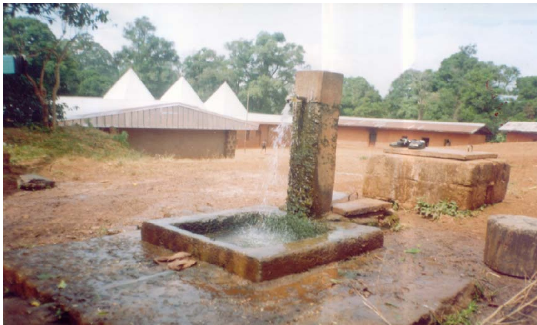
BORNE-FONTAINE MAL ENTRETENUE
