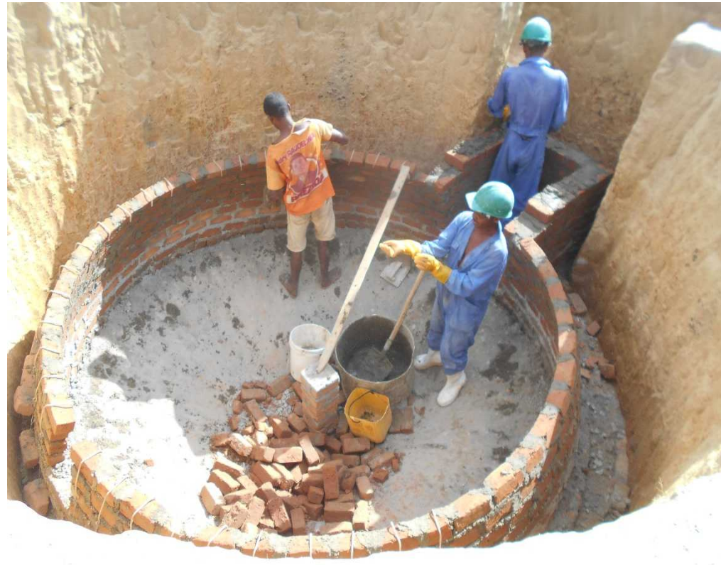
Biodigesteur à dôme fixe_Deen bandhu
