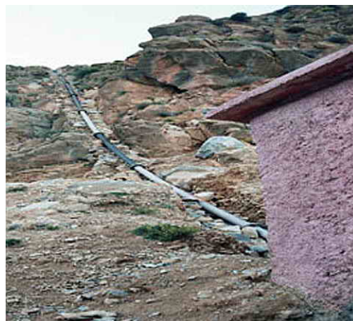
Fig. 2: Conduite forcée et centrale
