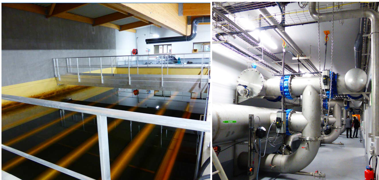
Le traitement de l'eau potable - Usine de production de la Roannaise de l'Eau Photo : Graie
