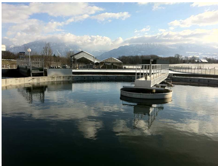
Le traitement des eaux usées Station d'épuration de Bellecombe Syndicat des Eaux des Rocailles et de Bellecombe Photo : Graie
