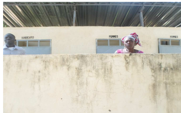
Image16 : Bloc de latrine contigu pour les deux sexes
