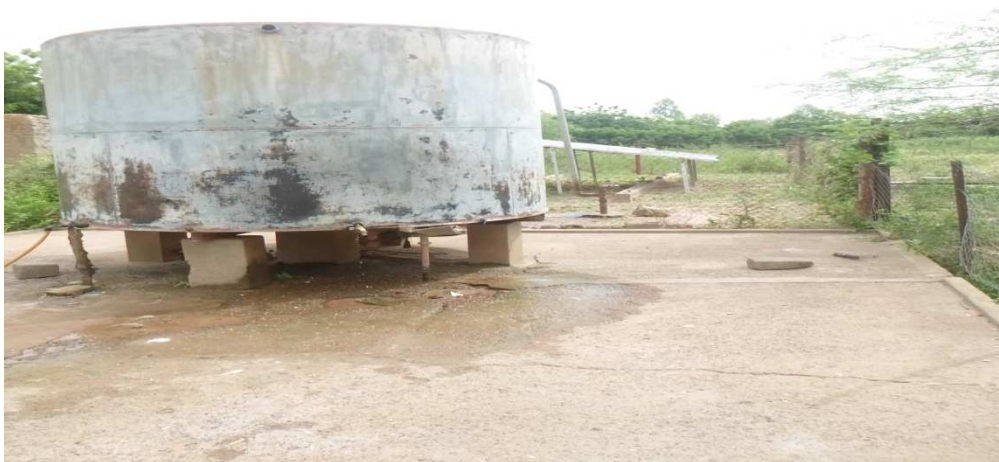
Image 6 : Vue générale d'un SHVA
