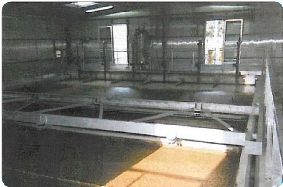
► Vue d'ensemble du flottateur de Dinan - Côtes d'Armor (photo extraite du Mémento du gestionnaire de l'alimentation en eau et de l'assainissement)
