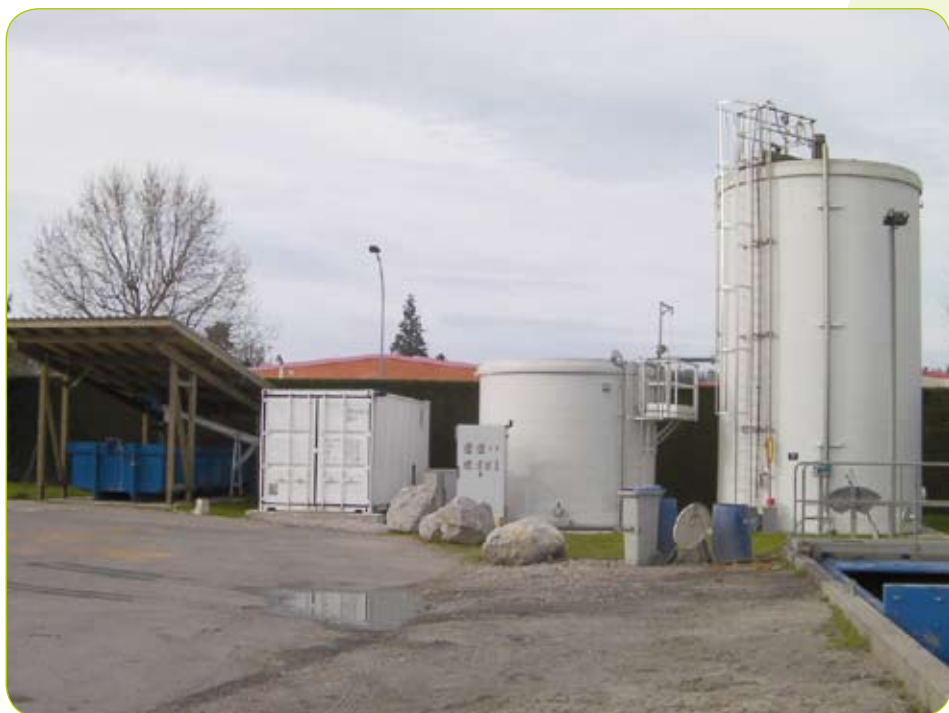
▶ Exemple d'installation Carbofil® dans l'Ain
