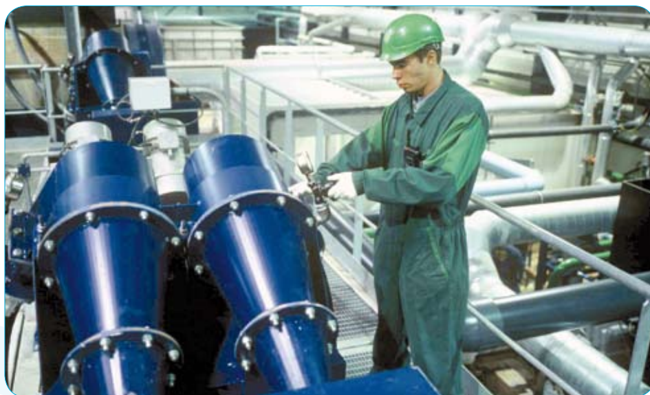
► Hydrocyclones en situation - Site de Bonneuil sur Marne
