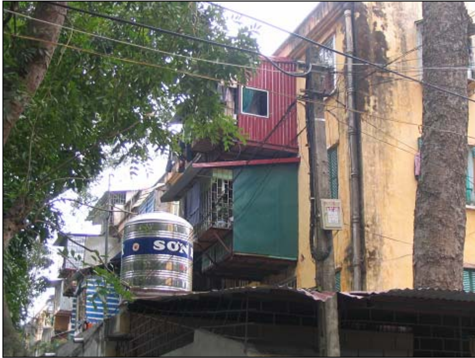
Avancées illégales sur les murs des immeubles pour augmenter la surface habitable des appartements surpeuplés d'Hanoi (Vietnam).
