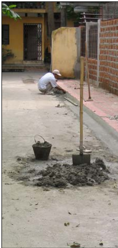
Construction d'un drain par les habitants d'un quartier de Hanoi (Vietnam) un an après la fin d'un projet de développement.
