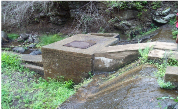
Fig. 8 – Vanne de départ de la nouvelle conduite (1989) sur la rive droite (Photo : Moira RASIKA)
