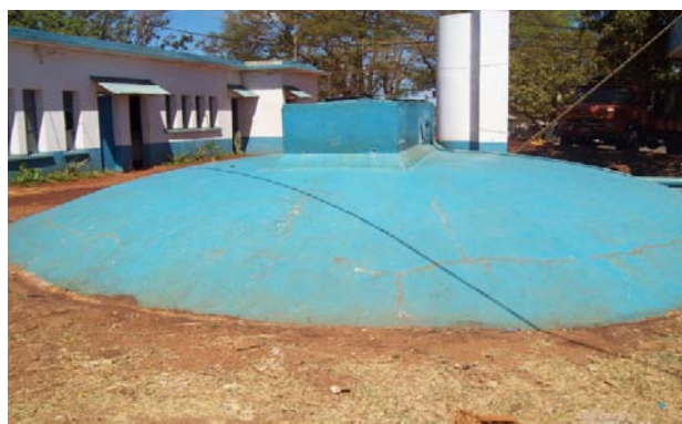
Fig. 12 – Bâche de reprise de 200 m 3 (Photo : Moira RASIKA)
