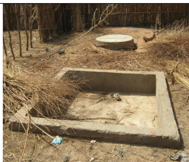
Bac à laver puisard mal entretenu à Soukou (ZP6, Kolda)
