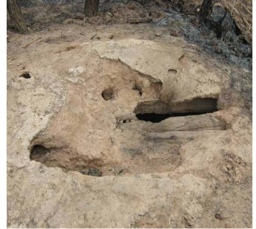
Latrine détruite par les eaux à Saré Lountang (ZP5, Kolda)
