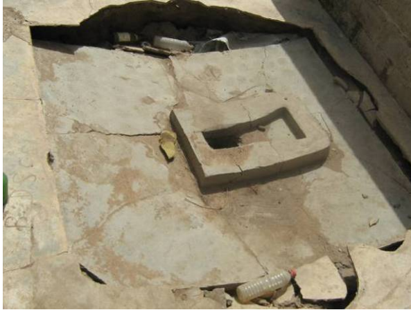
Affaissement d'une dalle de latrine à Saré Coly Sallé (ZHP6 ; Vélingara)
