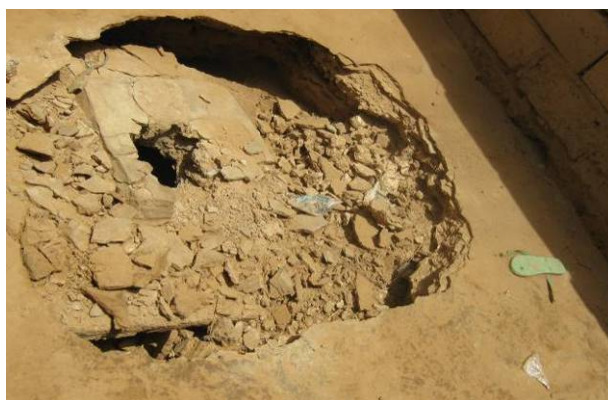
Affaissement d'une dalle de latrine à Ouro Mahdiyoy (Podor, ZHP3))
