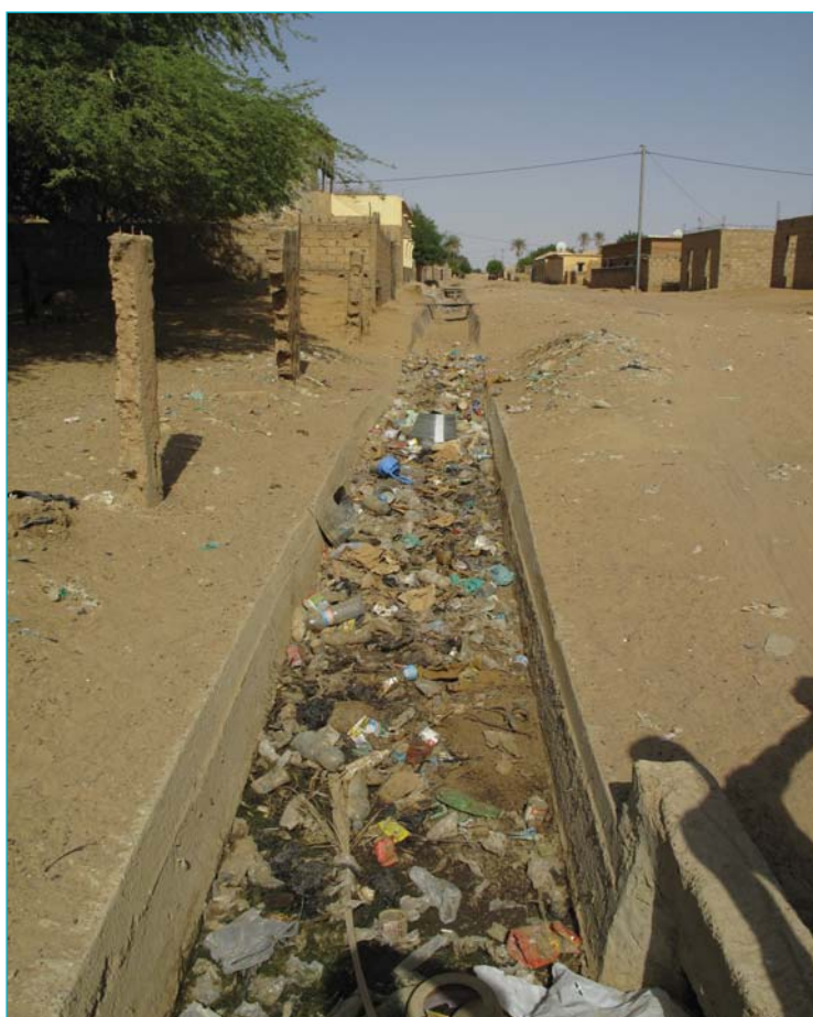
Photo 6 - Canal d'évacuation des eaux de pluie de la ville de Boghé obstrué par le sable et les déchets, avant son curage par la municipalité
