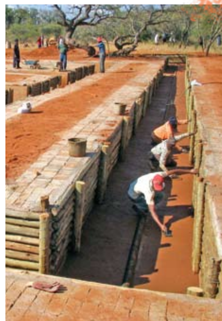
Plateforme d'entraînement à la pose de canalisations (Centre de formation en Afrique du Sud)
