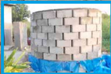
Utilisation de blocs de ciment lorsque les blocs d'argile ne sont pas disponibles.
