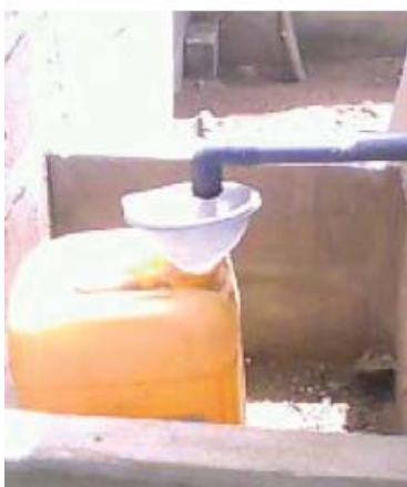
Photo 4 : Emplacement du bidon d'urine des latrines ECOSAN
