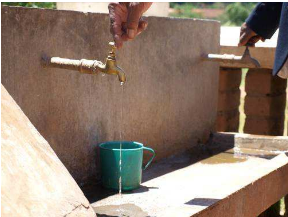
Adduction d'eau potable au CEG de Manandona (réalisation Vovonana Soamiaradia/Anjou Madagascar)
