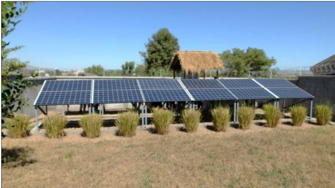
Photo des panneaux solaires
