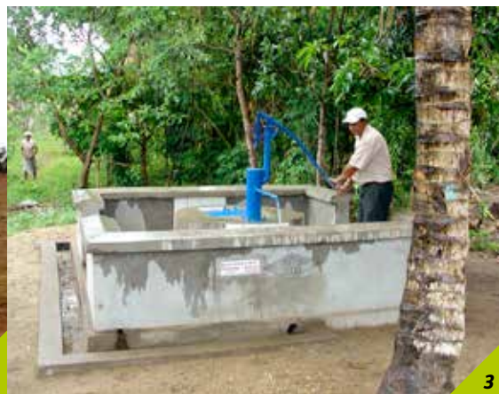
3 - Puits avec pompe manuelle
