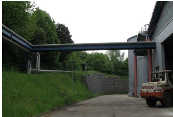
Installation de méthanisation de la fraction fermentescible des ordures ménagères Amt für Abfallwirtschaft à Karlsruhe en Allemagne.
