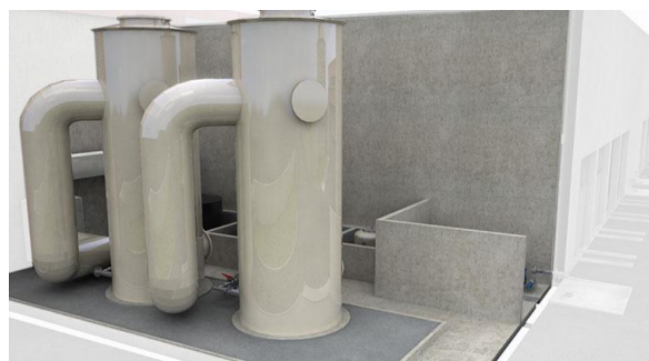
Figure 14: Tours de lavage. La première tour permet un lavage acide neutralisant l'ammoniac et la seconde un lavage oxydo-basique (soude/javel) pour réduire les composés soufrés (H 2 S, mercaptans...). Source : Communauté d'agglomérations du pays ajaccien.
