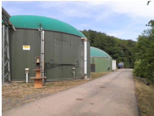
Installation de méthanisation à la ferme de M. Albert Schlafer à Falkenstein en Allemagne.
