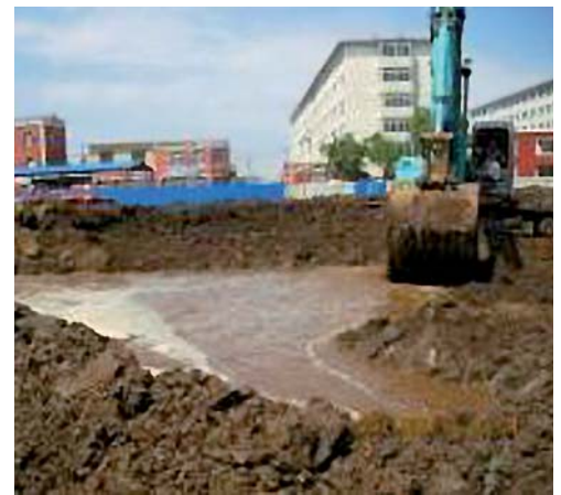
Pertes provoquées par un chantier mal organisé
