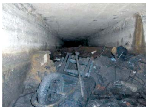
Divers déchets dans un collecteur d'eaux usées avant le nettoyage
