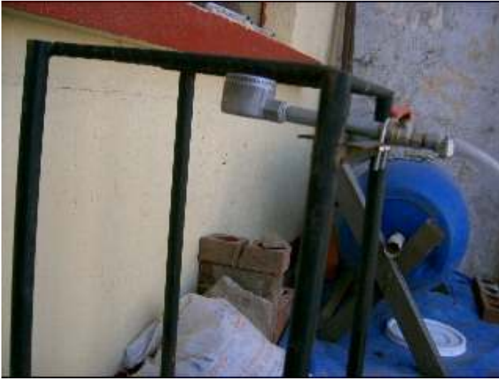
Photo 32. Le brûleur avec son support en métal
