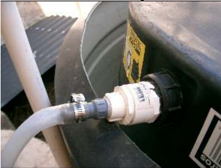
Photo 31. Connection de la sortie de gaz
