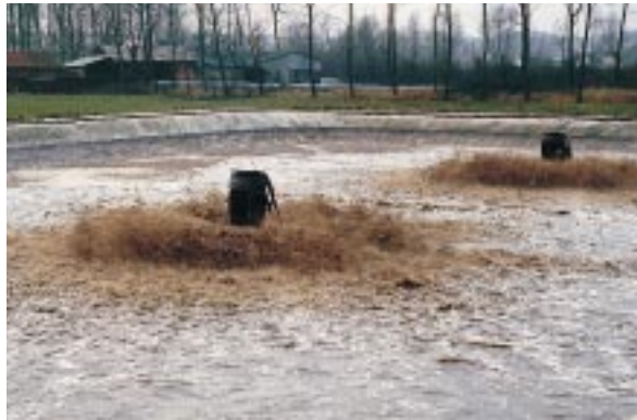
LAGUNAGE AÉRÉ (BASSIN ÉTANCHÉ PAR BÂCHE).
