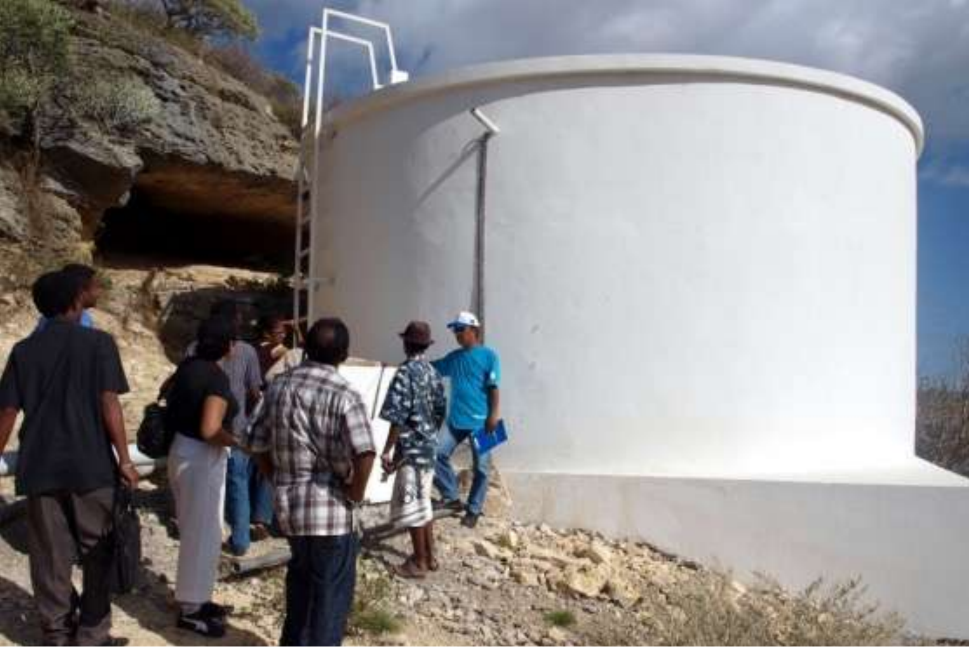
Stockage - Réservoir St Augustin
